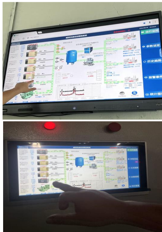
中央空壓系統操作介面
