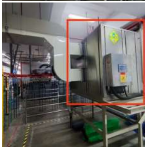
1 台熱泵高溫熱風機
