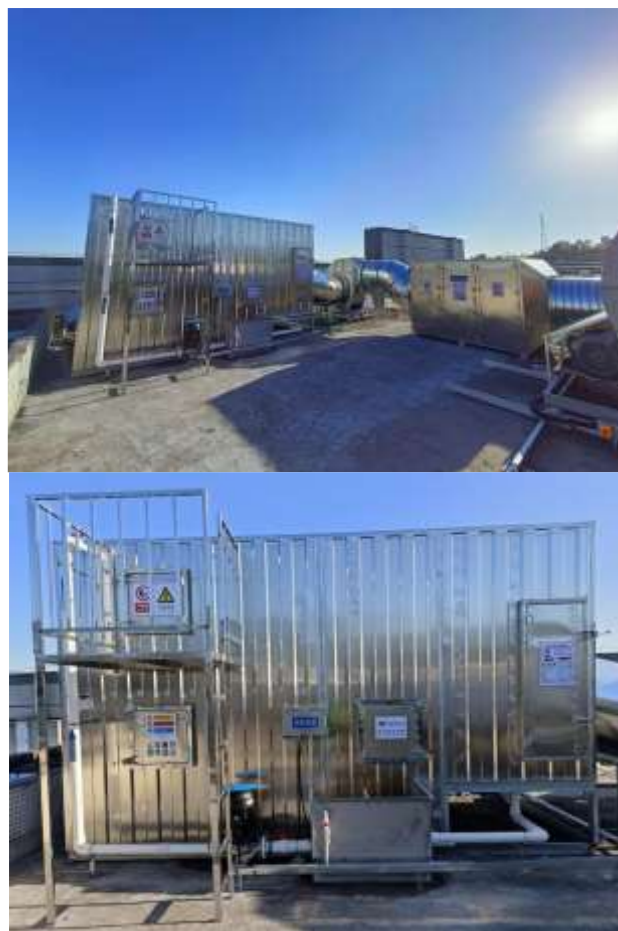
化學洗滌及活性炭吸附設備
