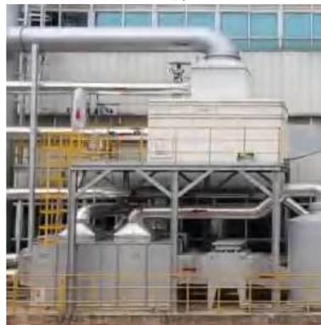
催化燃燒設備
