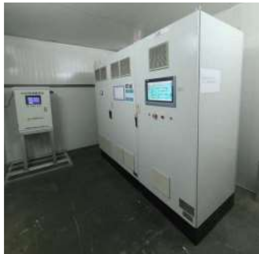
設備操作介面
