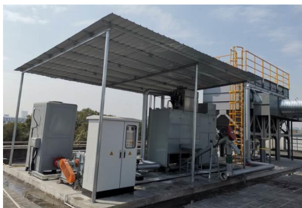
沸石吸附濃縮、自動脫附及催化分解設備
