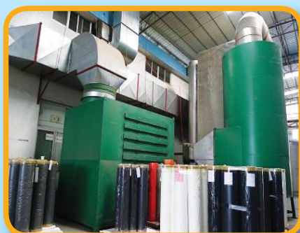
有機廢氣的前處理過濾系統
