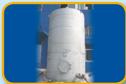
丙酮回收儲存罐
